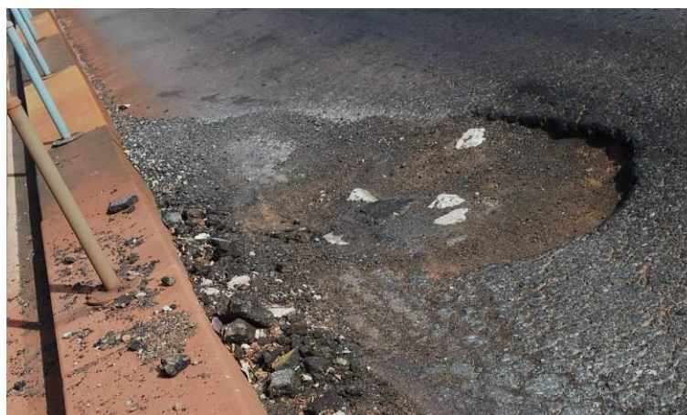
Figura 7. Panela no pavimento (AUTORES, 2023).
