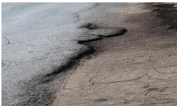
Figura 5. Escorregamento no pavimento (AUTORES, 2023).
