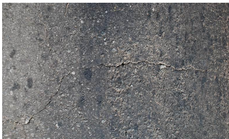
Figura 2. Trincas no pavimento (AUTORES, 2023).
