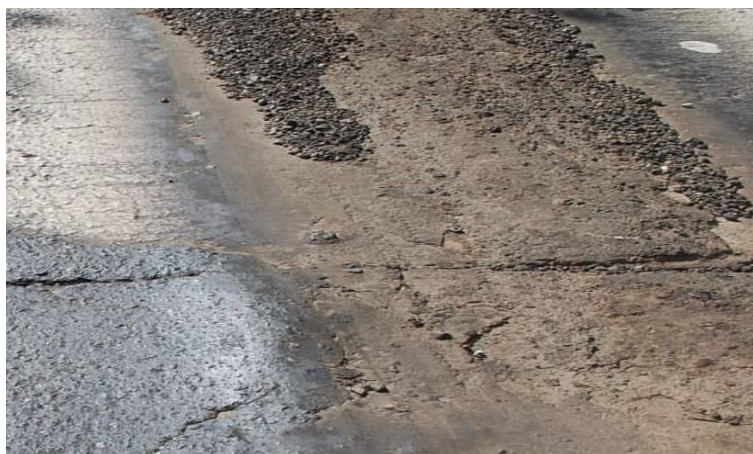
Figura 3. Desgaste no pavimento (AUTORES, 2023).
