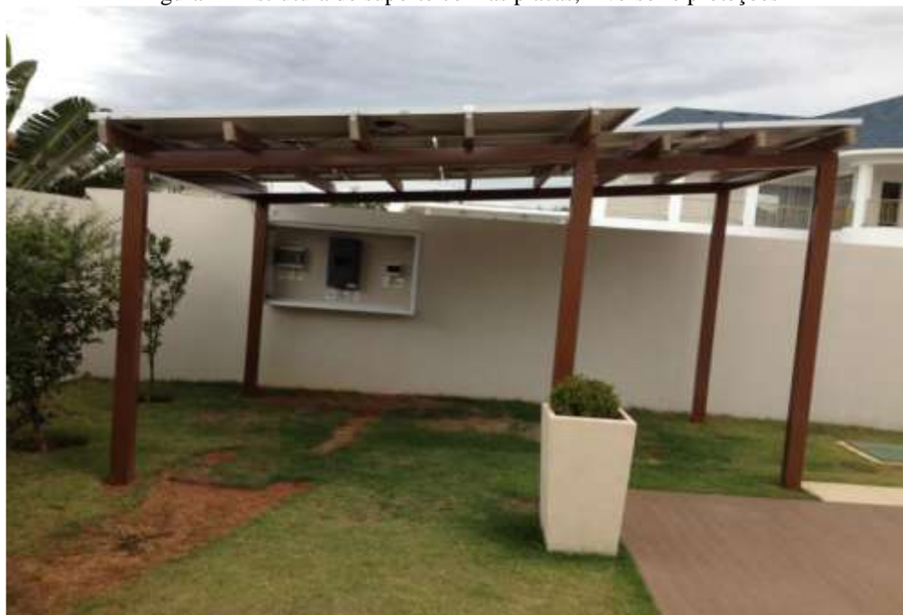
Figura 1 - Estrutura de suporte com as placas, inversor e proteções
