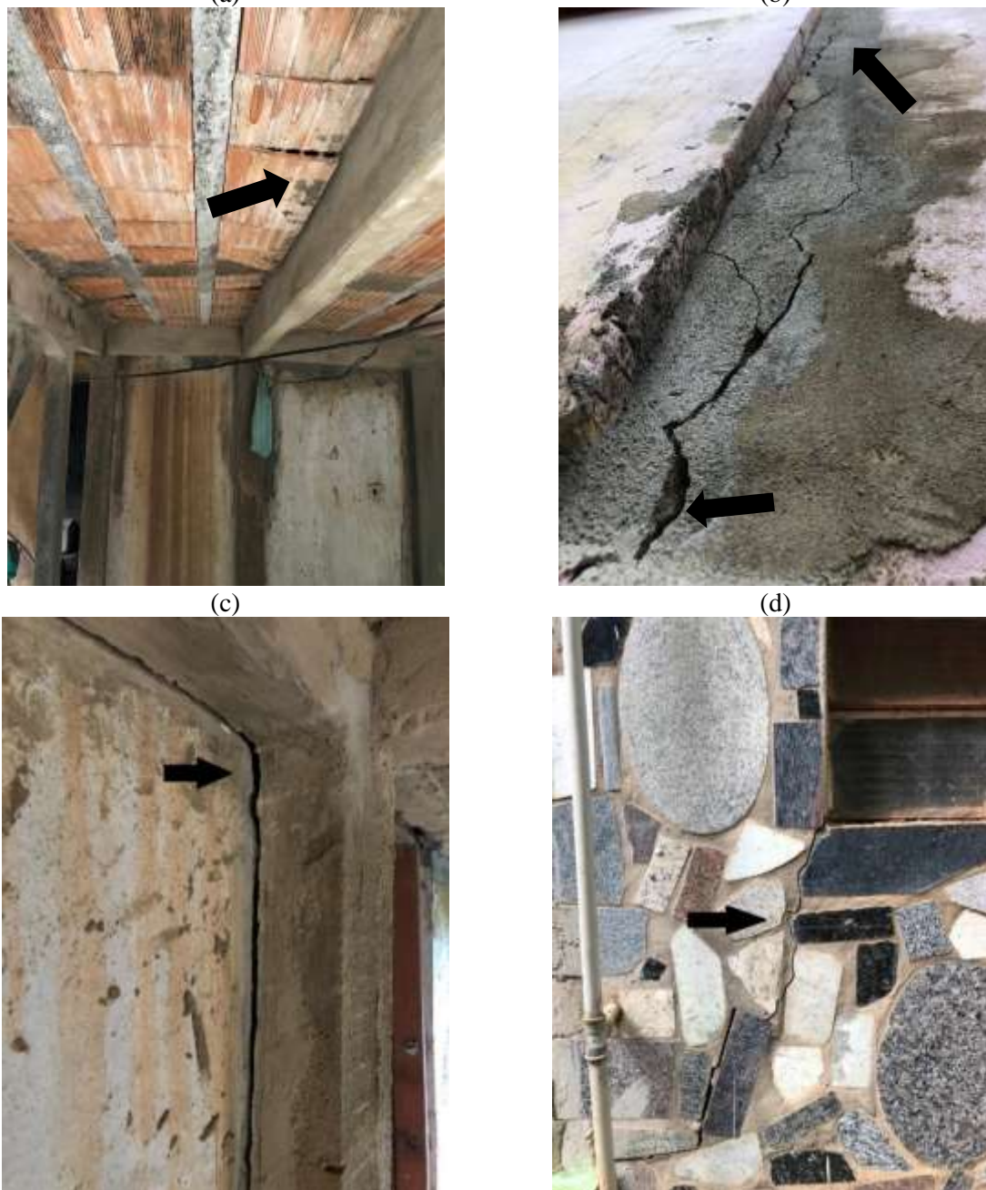
Figura 6 – Patologias encontradas no pavimento inferior da edificação: em (a) deformação na laje; (b) fissuração; (c) rompimento do pilar com a parede; (d) fissuração.
