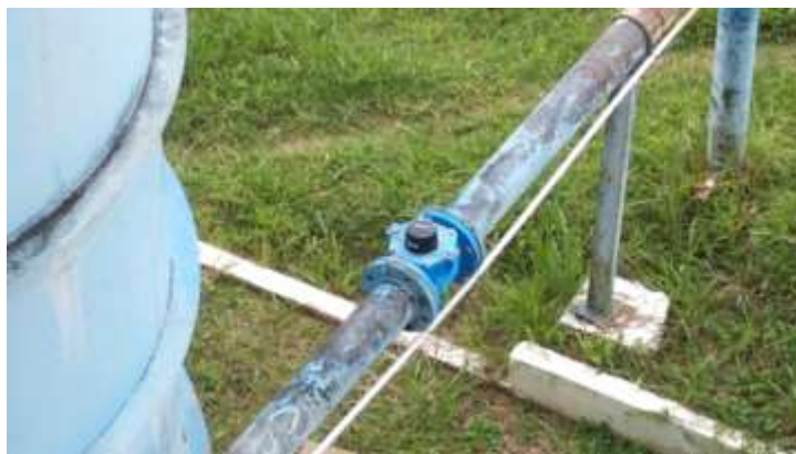
Figura 2 – Medidor de Vazão localizado na saída dos Filtros (ETA).
