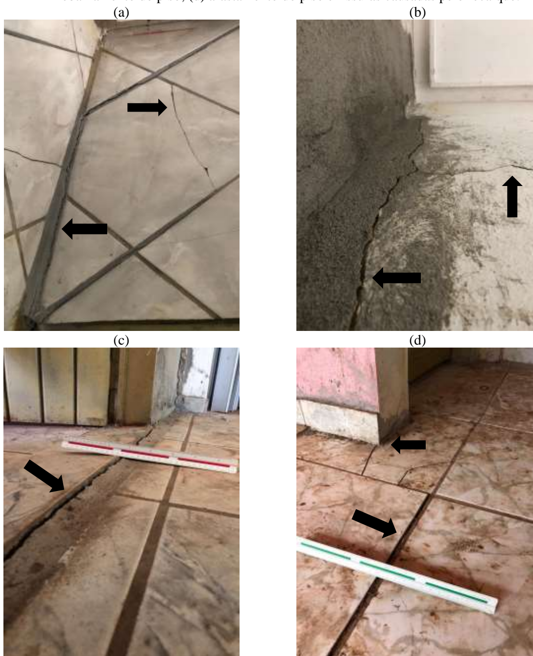
Figura 8 – Fissuras provocadas pelos movimentos de retração e expansão do solo: (a) fissuração no vértice superior na parede interna; (b) fissura no canto superior da parede, próxima ao pilar; (c) rompimento e rebaixamento do piso; (d) afastamento do piso e fissuras causadas pelo recalque.
