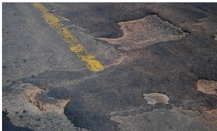
Figura 6. Remendo no pavimento (AUTORES, 2023).
