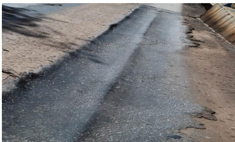
Figura 4. Afundamento no pavimento (AUTORES, 2023).
