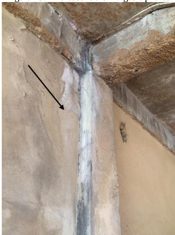
Figura 13: Eflorescência em vigas e pilares.
