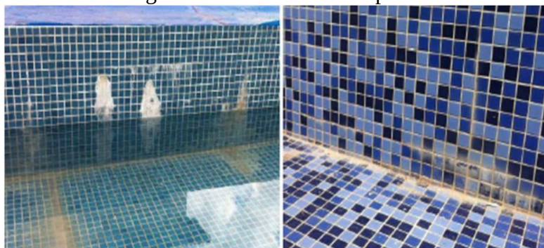
Figura 5: Eflorescência em pisos.
