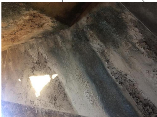
Figura 12: Mofo da parte interior da obra (escada).
