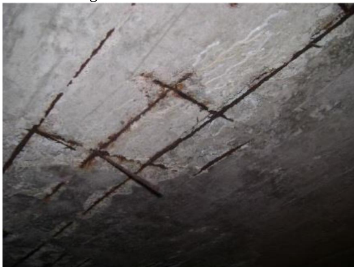
Figura 3: Corrosão da armadura.
