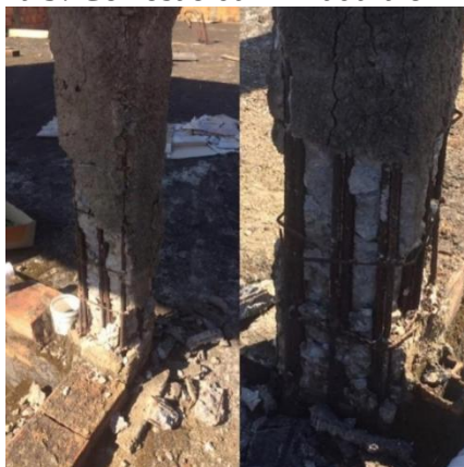
Figura 9: Corrosão da Armadura em Pilar.
